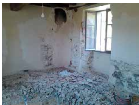
Destruction des sols avant isolation.
